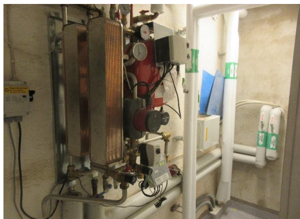
Undercentral för värme och varmvatten.
