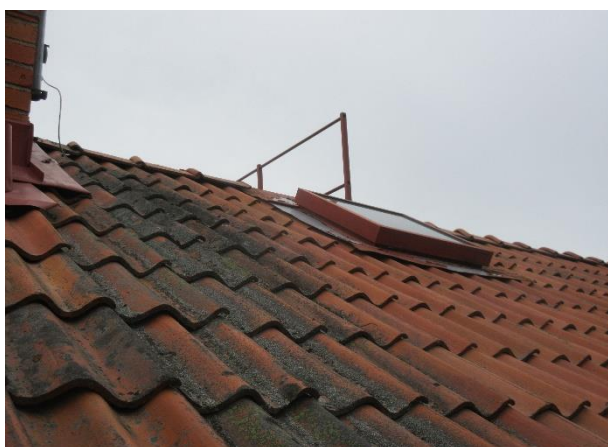
Taklucka vilken är igensatt från insidan
