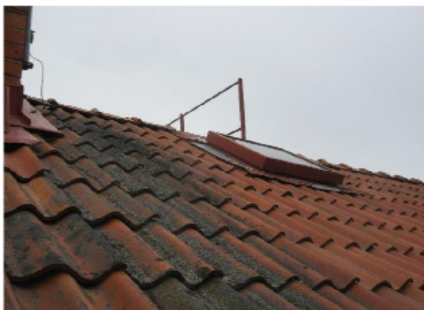
Taklucka vilken är igensatt från insidan
