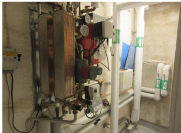
Undercentral för värme och varmvatten.
