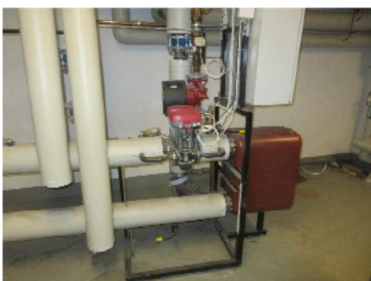
Undercentral för tappvarmvatten
