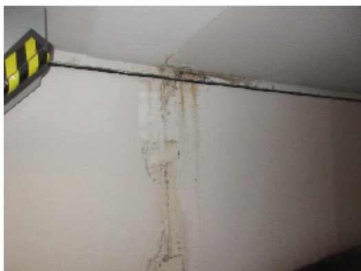
Läckage i garaget
