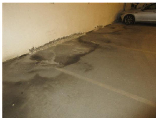
Fukt sugts upp i yttermur i garaget
