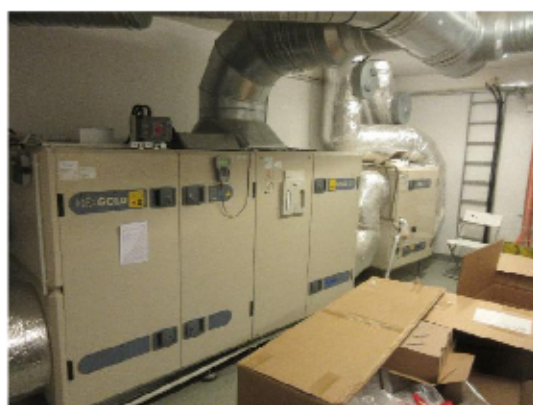
Ventilationsaggregat för allmänna utrymmen
