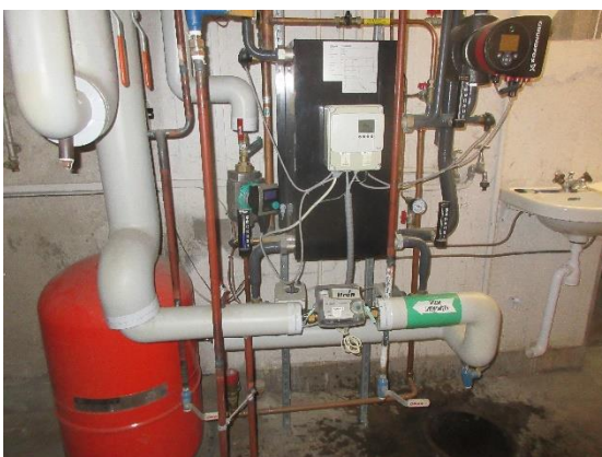
Undercentralen för värme och tappvarmvatten
