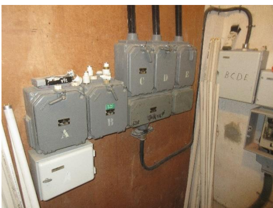
Elektriska installationer som är gamla
