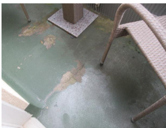
Ovansida i sämre skick, spricka och äldre ytskikt
