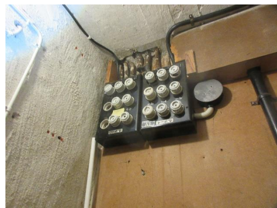
Säkringar från byggnadsåret.
